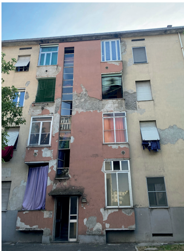
UNA FACCIATA DELLE CASE POPOLARI DI VIA LORENTEGGIO A MILANO: DEGRADO E INCURIA (ph. Davide Battista).
